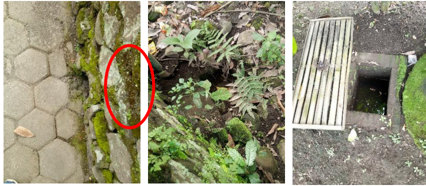
Gambar 5. Kondisi peresapan dan sumur resapan yang ada di Desa Brayut Sumber: Dokumentasi Kinanthi, 2021
