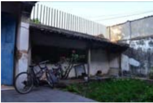
Gambar 19. Tembok bangunan 2. Sumber: Dokumentasi Christian, 2017.
