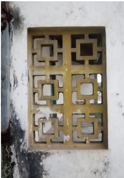
Gambar 6. Lubang pada pagar rumah tinggal di Lasem
